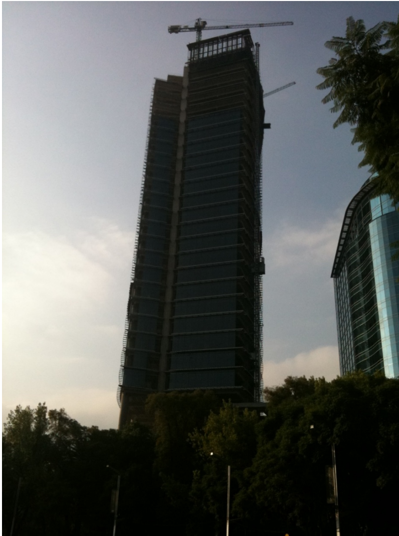
FIG. TT (imagen donde se observa el elevador exterior para el personal).
