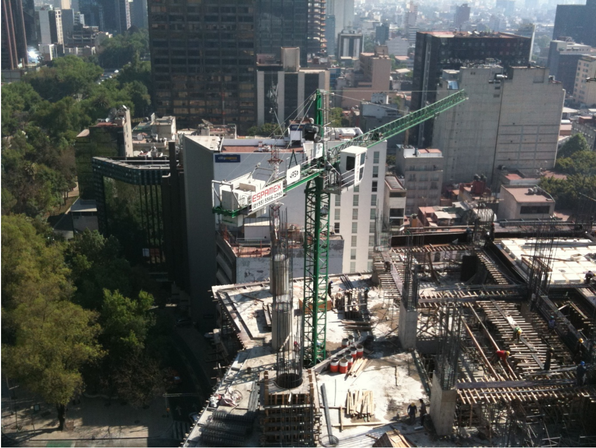
FIG. EE (El apoyo de las grúas torre fue clave en el avance).
