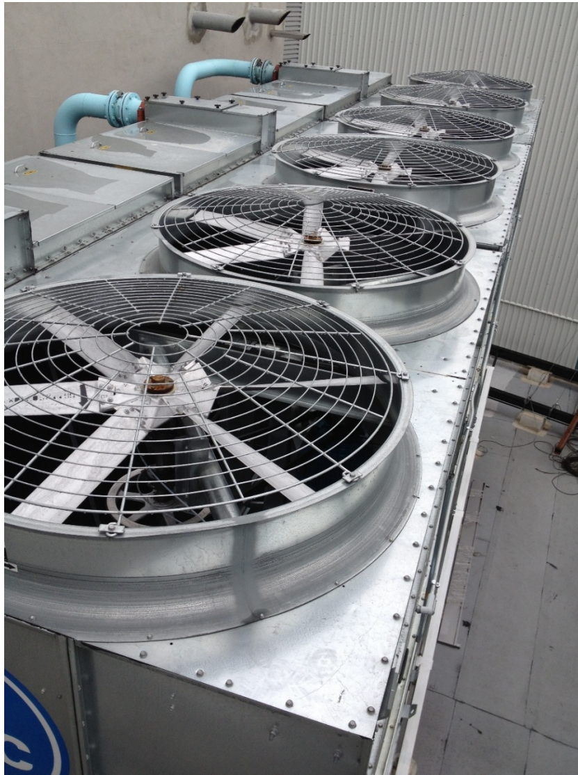
FIG. X (imagen de los equipos en azotea de aire acondicionado)
