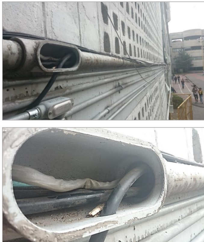
Figura 12. Canalización vertical correspondiente del cuarto de equipos al edificio B.
