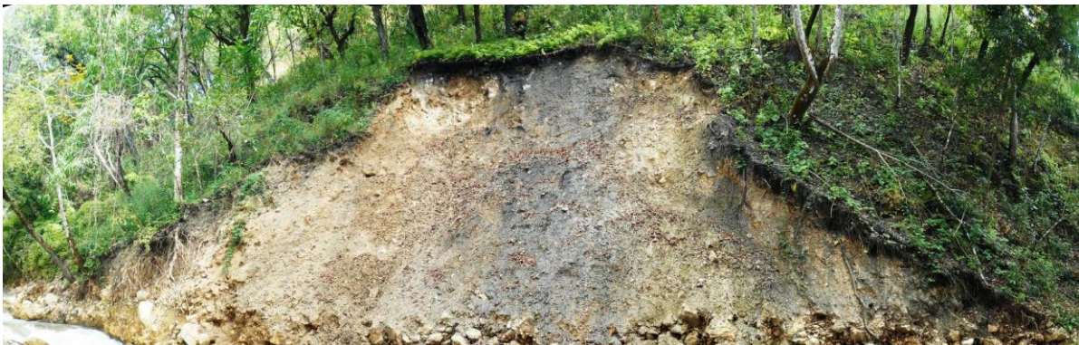
Fotografía 62. Vista de un deslizamiento de la ladera de la margen izquierda de depósitos de talud. Este sitio se encuentra aguas arriba del eje de cortina de la obra de toma.
