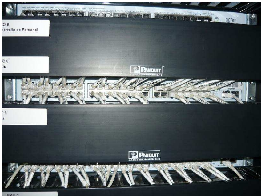
Imagen 5.4 Switches en piso 8
