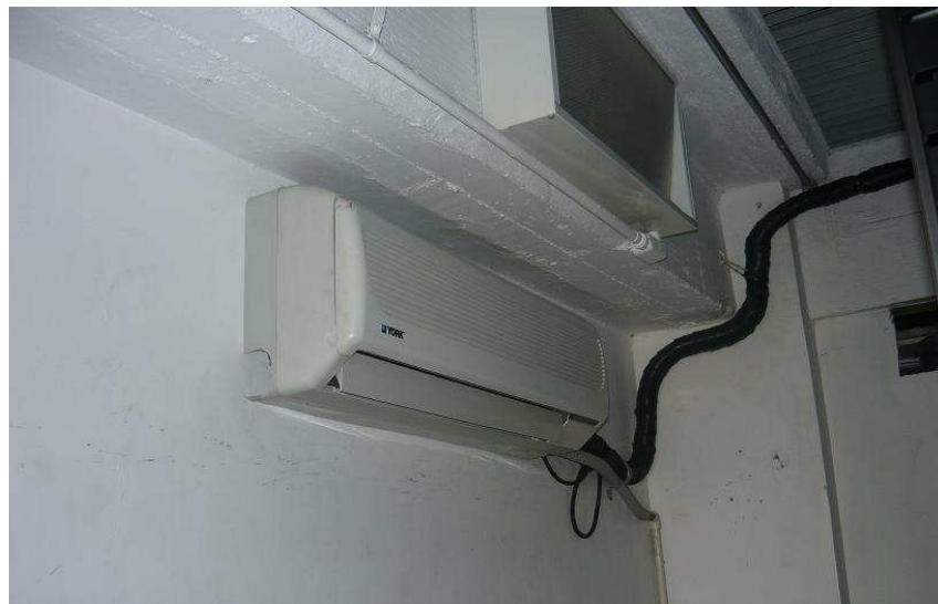
Imagen 4.1 Sistema de aire acondicionado
