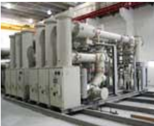
Figura 6.4 Subestación Eléctrica de Alta Tensión (SEAT)
