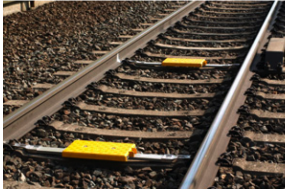
Figura 4.1: Baliza montada en vía
