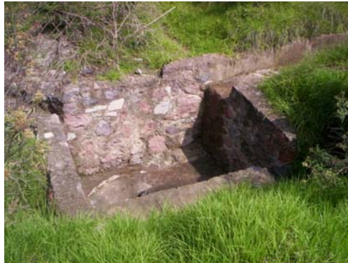
Fotografía No. 8 Caja de captación
