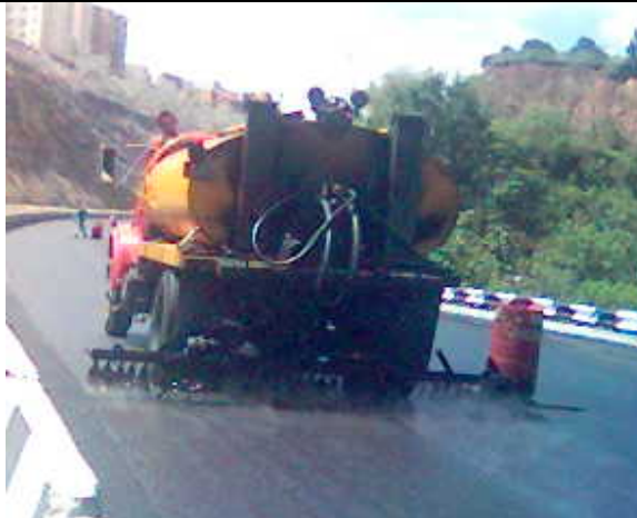
Riego de liga para la adherencia de la base negra y la microcarpeta
