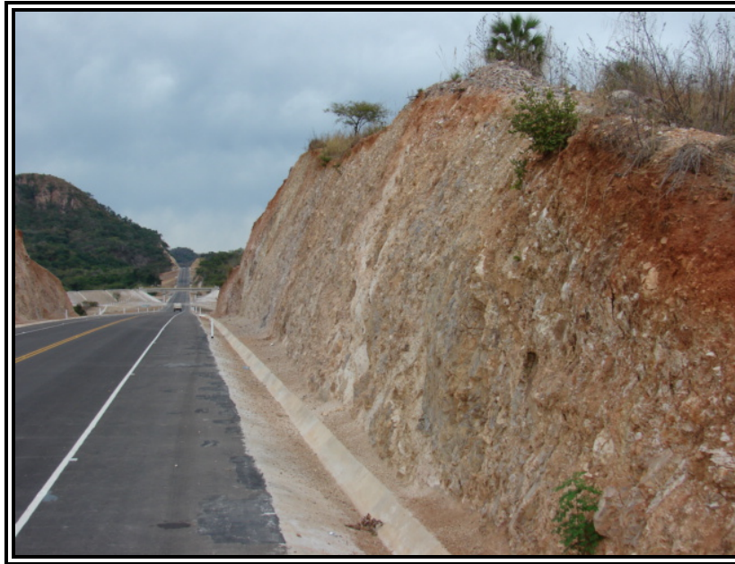
Figura 5. Cuneta al pie del Corte
