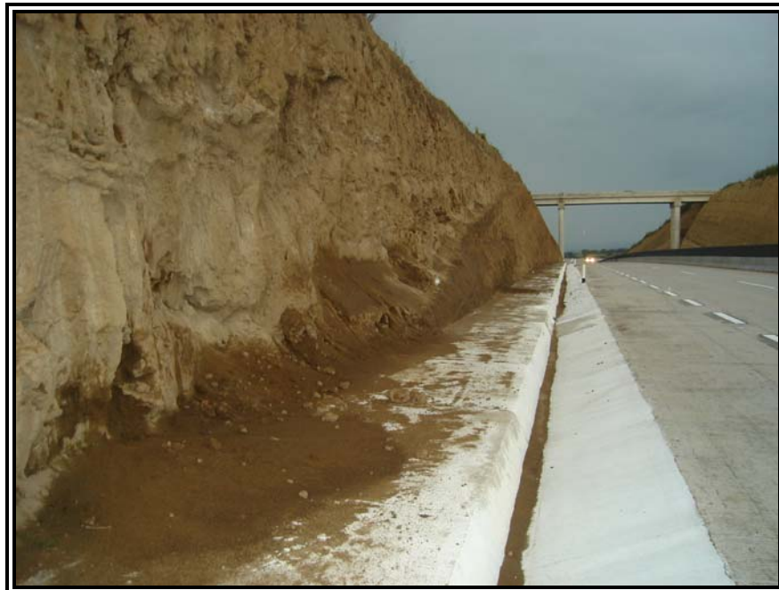
Figura 47. Caído de finos sobre la banqueta
