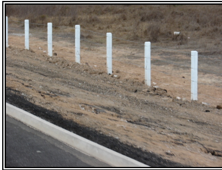
Figura 3. Bordillo a la orilla de la calzada
