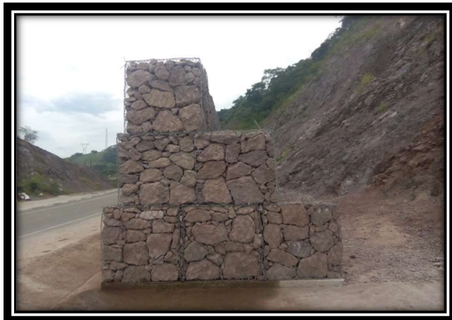
Fig. 34 Talud km 197+500 (vista después de los trabajos) EP- 05 Construcción de contracunetas (murete de mampostería)
