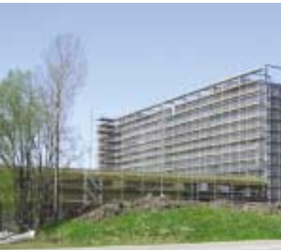
La presión de plazos y costes está a la orden del día en las inmobiliarias. El hormigón armado de fibra, p.ej. como capa de hormigón sobre losas prefabricadas, suele ser una interesante alternativa.
